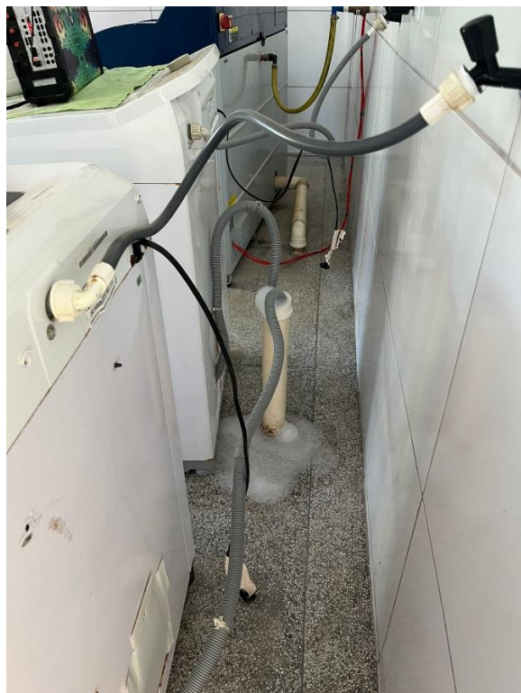
Foto 01 – Lavanderia em funcionamento
