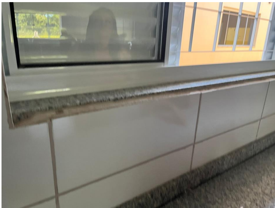
Foto 02 – Janela da cozinha sem acabamento
