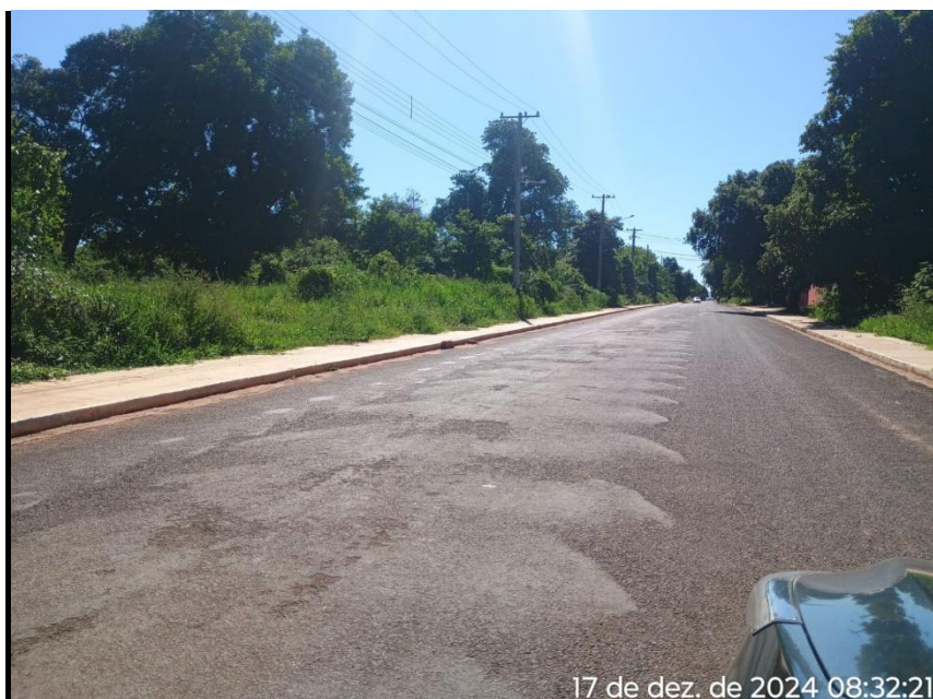
Ausência de sinalização horizontal
