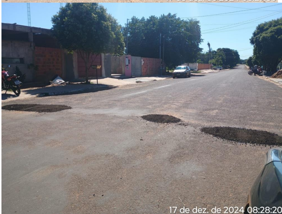
PATOLOGIA NO PAVIMENTO
